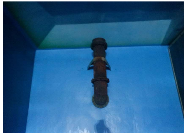
배수지 2지 유입배관 관부식
