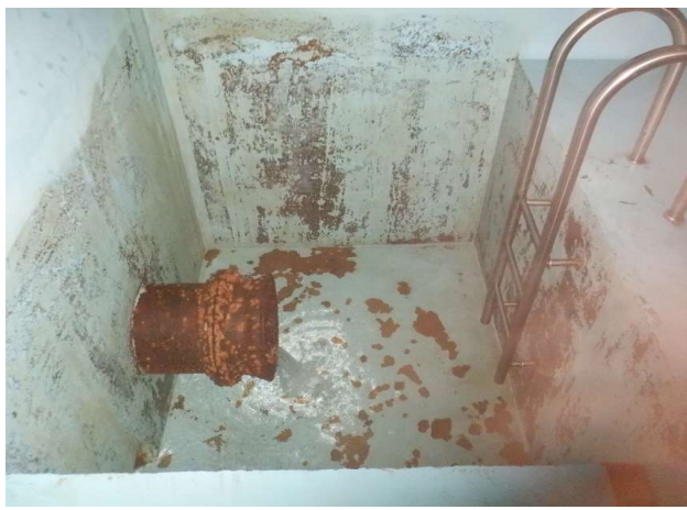
배수지 1지 유출배관 관부식 / 차수불량
