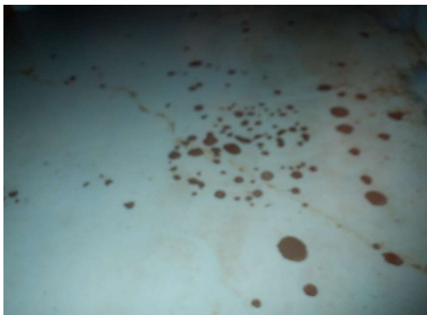
배수지1지 하부슬래브 도장박리
