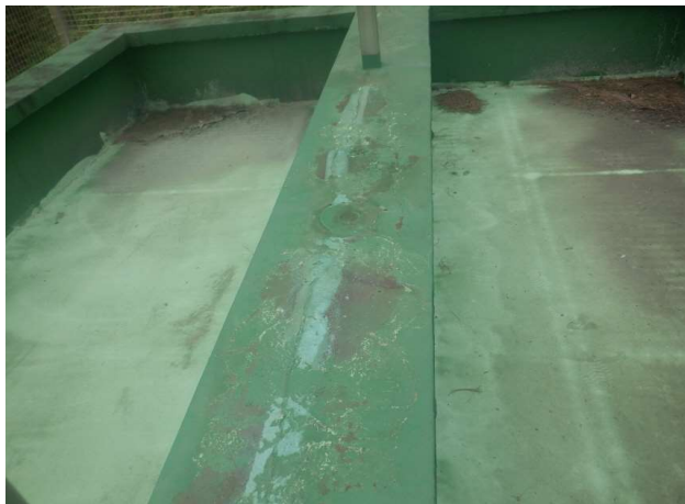
건축물 옥상층 균열(모르타르)
