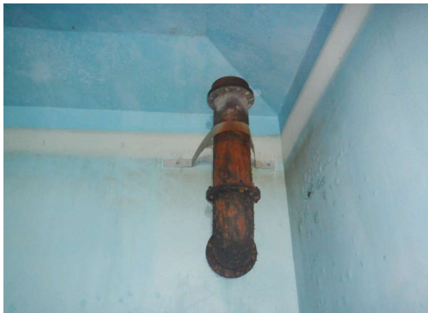
배수지 1지 유입배관 관부식
